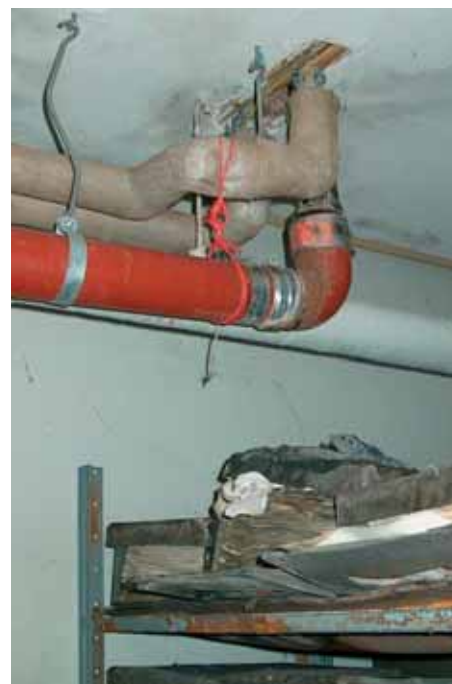
Vand fra utætte rør kan gøre stor skade på arkivalier og hører ikke hjemme i et arkivlokale.
