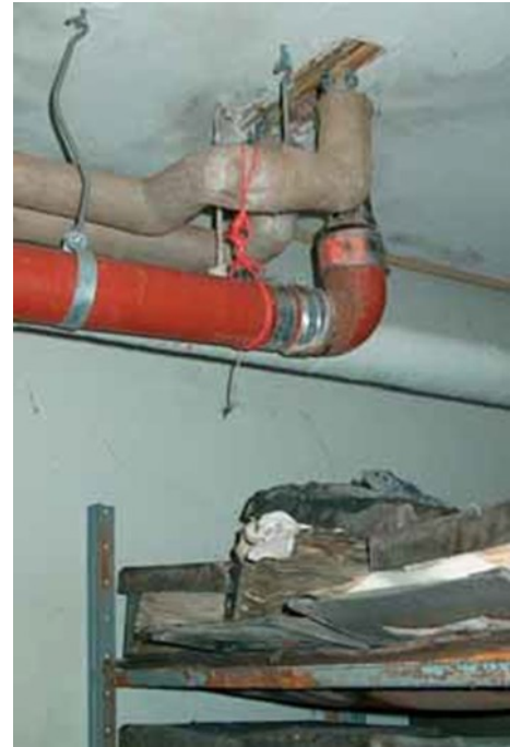
Billede 2: Vand fra utætte rør kan gøre stor skade på arkivalier og hører ikke hjemme i et arkivlokale
